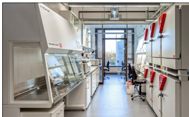
Komory do bezpiecznej pracy mikrobiologicznej (Microbiology Safe Cabinet) w jednym z pomieszczeń Nephrolab Laboratory Uniwersytetu w Kolonii, Niemcy
